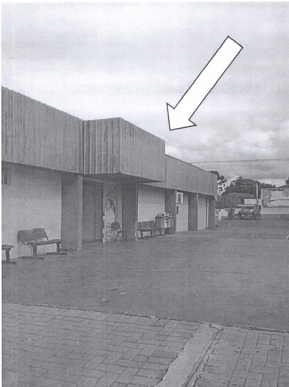
FIGURA 1. Local da entrada principal da UBS-CENTRO, sem cobertura para abrigo dos pacientes. E, a parte em metal de zinco, sobre a entrada que atrapalha a ambulância do SAMU, que são mais altas do que as mais antigas.
